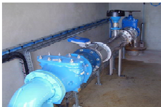
Pompage profond des Petits Eynards à Alixan
